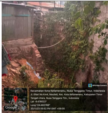
Gambar 4.9 Tampak Luar Tempat Pembuangan Air Limbah
