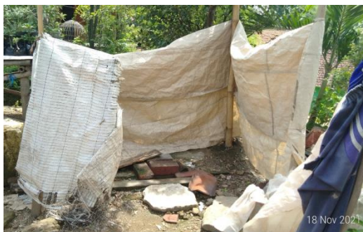
Wc masyarakat yang tidak layak digunakan
